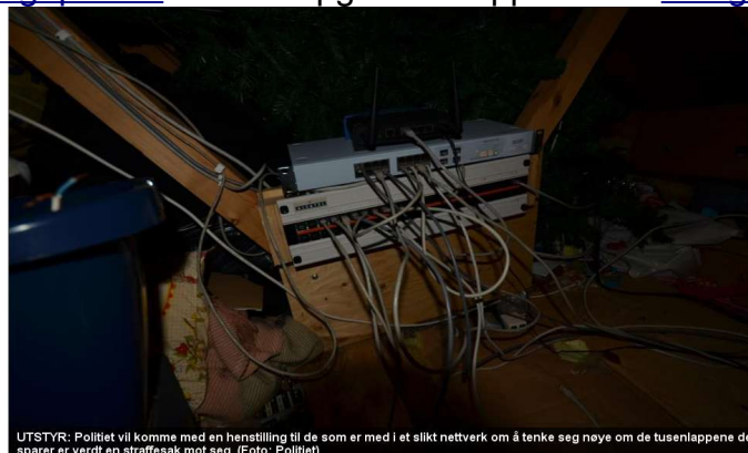
UTSTYR: Politiet vil komme med en henstilling til de som er med i et slikt nettverk om å tenke seg nye om de tusenlappene de sparer er verdt en straffesak mot seg. (Foto: Politiet)
